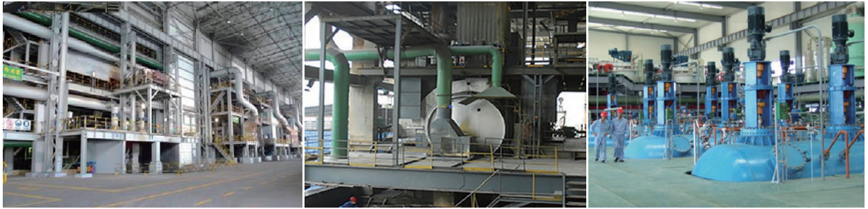
▲ 白银有色集团股份有限公司西北铅锌冶炼厂锌冶炼资源综合利用项目
